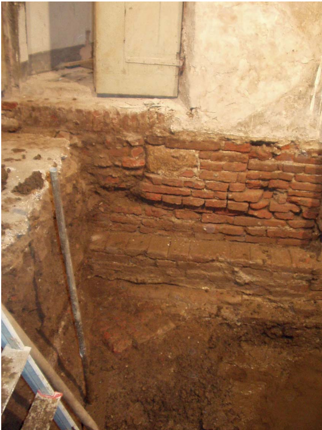
Fig.3 - Foto di scavo con le fasi più antiche raggiunte: in basso si vede la pavimentazione US 71.
